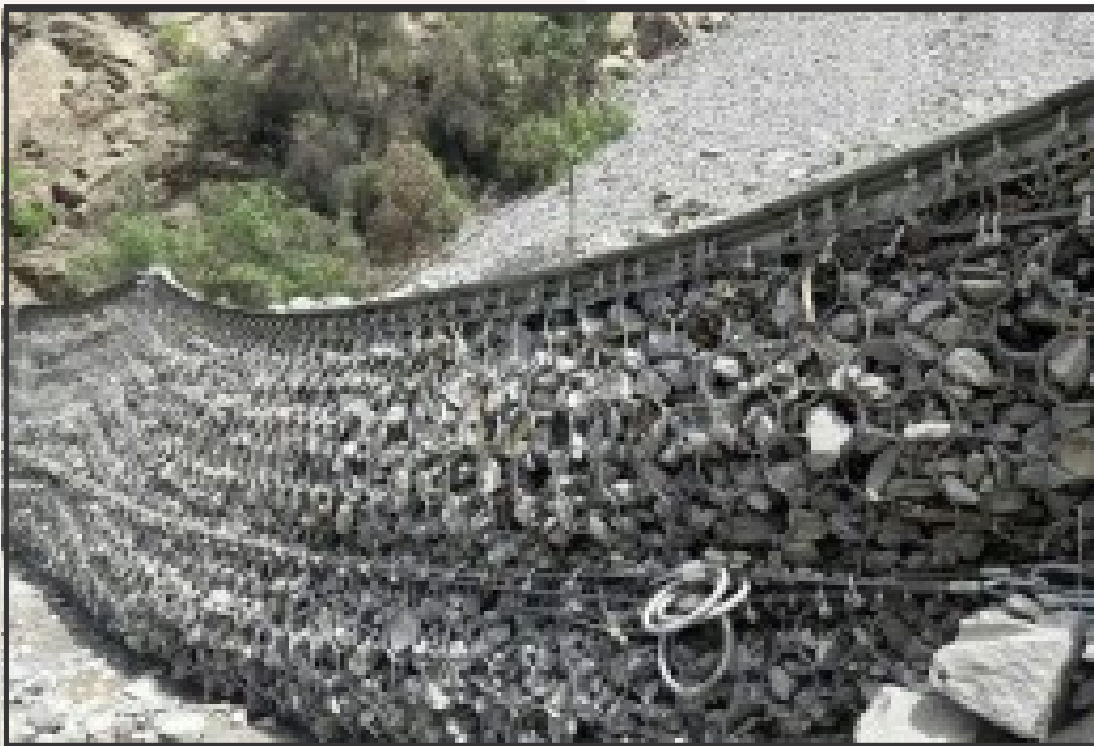
Figura 17. Vista del segundo nivel de barreras donde se atraparon cerca de 3.000 m 3 de sedimentos. Fuente: Geobruigg (2017a).
