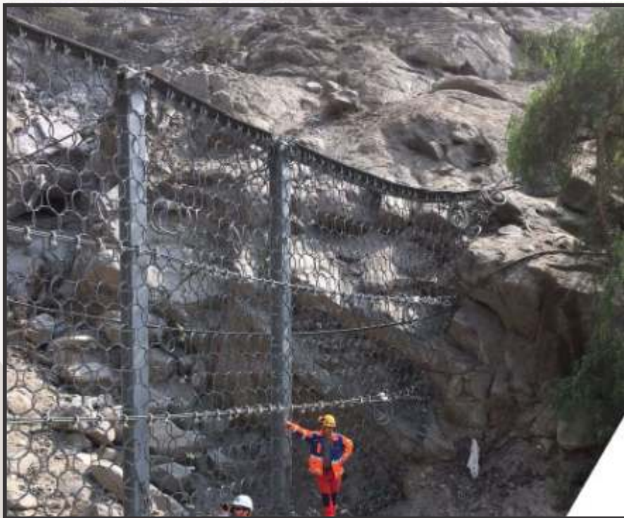
Figura 14. Vista lateral cercana de una de las barreras de 6 m de altura instaladas en Chosica. Fuente: Geobruigg (2017a).
