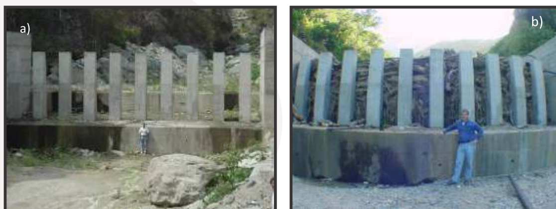
Figura 30. Presa abierta ranurada en la Quebrada Guanape. Izquierda: vista frontal desde aguas abajo después de finalizada la construcción en mayo 2001; derecha: vista después de la crecida de diciembre 2001. Fuente: López et al (2010).
