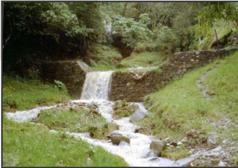
Figura 51. Vista del tramo recuperado de la quebrada La Virgen en Hm 2+50. Los daños por erosión que se observan en la cresta de la presa de gaviones ponen en evidencia la necesidad de mantenimiento de la obra. Fuente: Hernández (2006).
