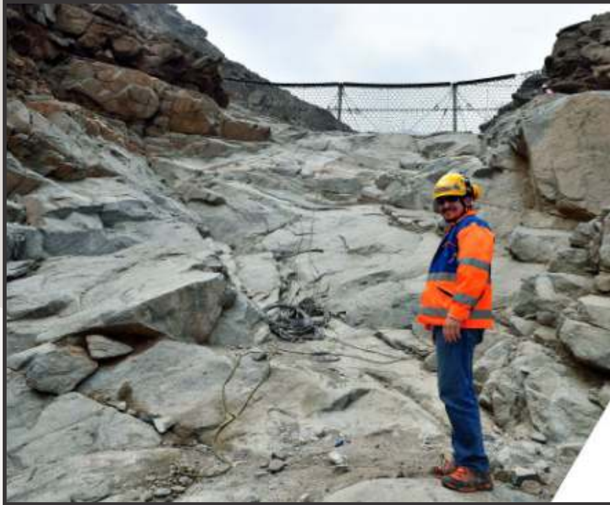
Figura 13. Vista del cauce torrencial de alta pendiente donde se han instalado barreras de protección en Chosica. Fuente: Geobruigg (2017a).
