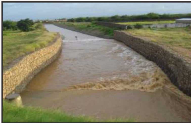
Figura 63. Vista de la canalización del río San Juan operando durante una creciente. Se observa desde aguas arriba el área de la obra de entrada, disipador y transición 1, al fondo el área urbanizada. Fuente: MARNR-MGR Consultores (2002).
