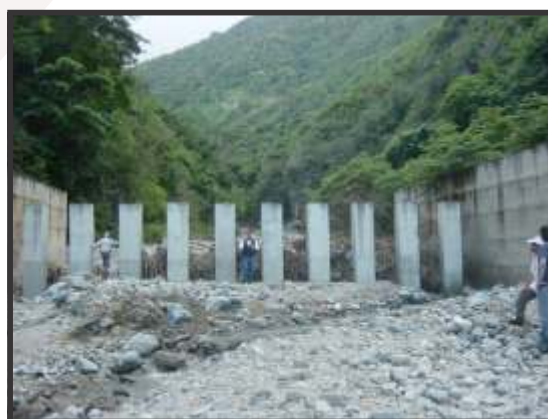
Figura 31. Vista desde aguas abajo de la presa de Guanape después de la crecida de febrero 2005, mostrando la capacidad de auto-limpieza de la presa, capaz de remover los sedimentos atrapados. Fuente: López et al (2010).
