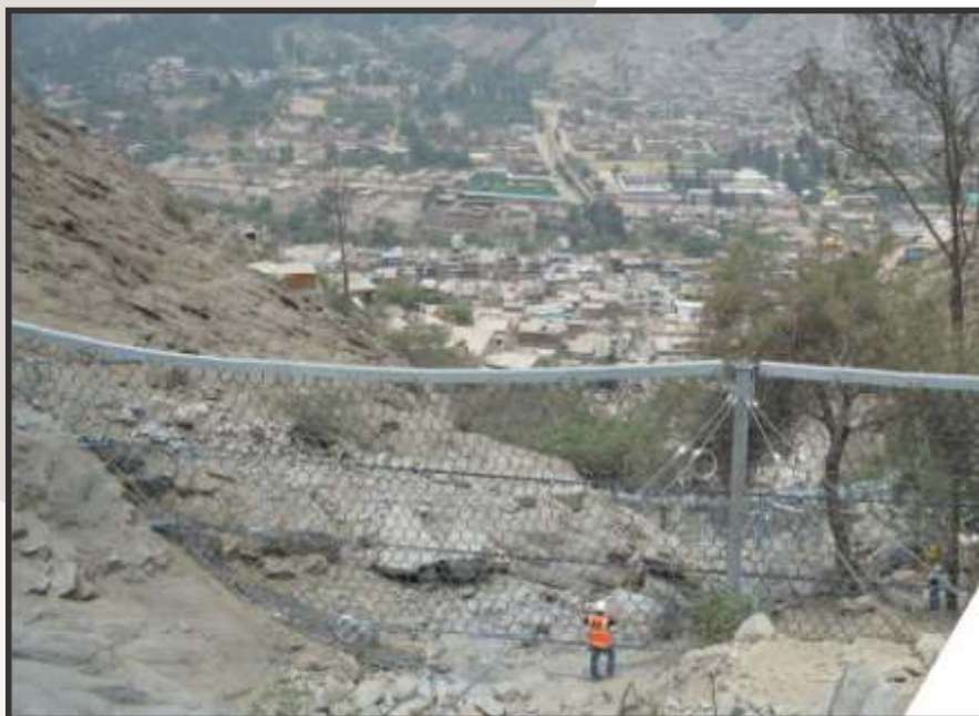
Figura 11 . Vista hacia aguas abajo de una barrera de protección contra deslaves en las montañas de Chosica en Lima. Fuente: Geobruigg, (2017a).
