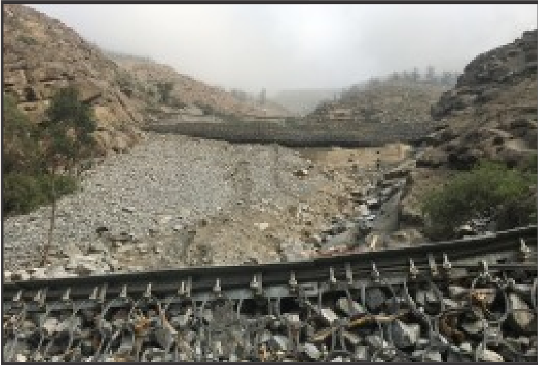
Figura 18. Vista hacia aguas arriba desde el segundo nivel hasta el primer nivel de las barreras colmatadas de sedimentos. Fuente: Geobruigg (2017a).
