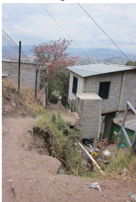
Foto 14: Gradas colapsadas y letrina en riesgo, Los Pinos
