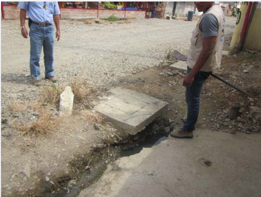
Abajo: Filtración de aguas residuales de una línea de red recientemente construida en una zona residencial (resumen de caso nº 3)
