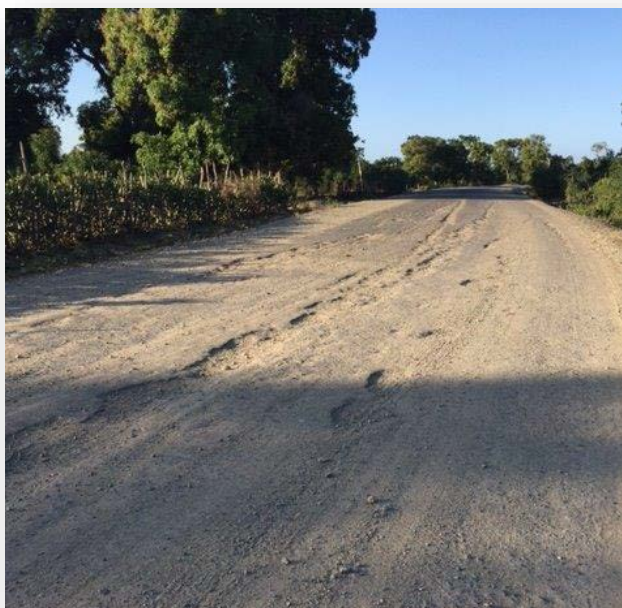
Camino en deterioro poco después de pagar íntegramente el contrato
