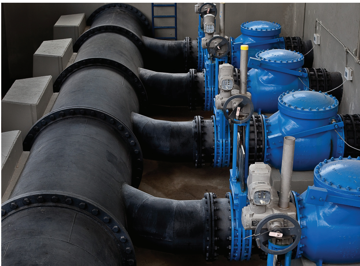
Estación de bombeo de aguas residuales. Aguas de Cartagena, Colombia
