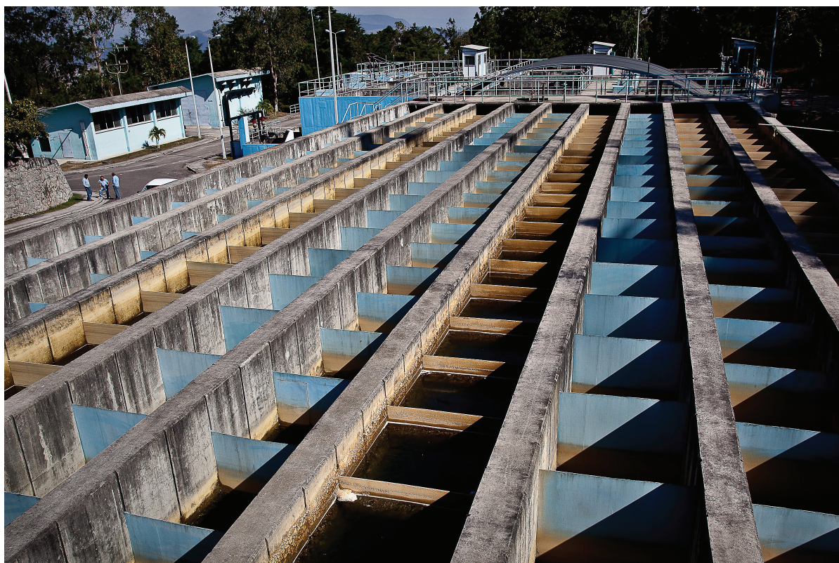
Planta de tratamiento de agua potable. Tegucigalpa, Honduras
