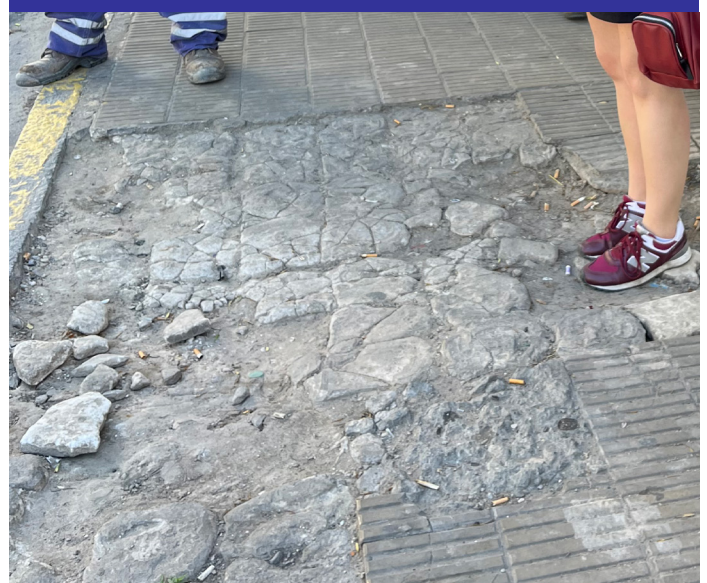
FIGURA 14. VEREDAS CON GRIETAS
