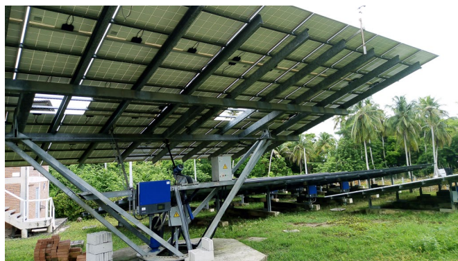
Módulo móvil con sistema de seguimiento. Isla Fuerte.
