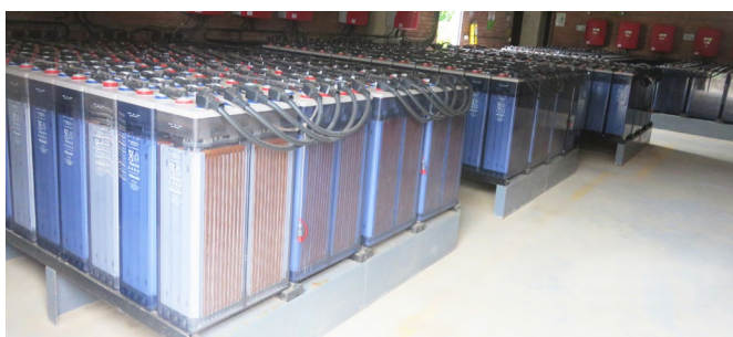
Cuarto de baterías, Isla Fuerte.
