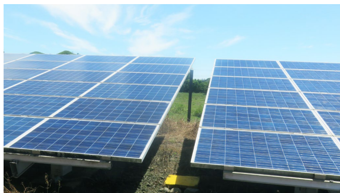
Módulos fijos en la planta fotovoltaica. Titumate.
