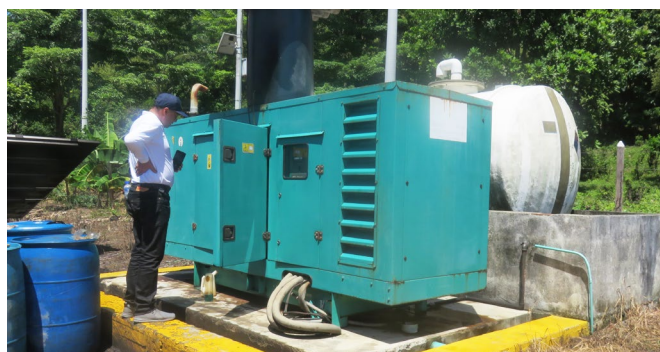
Derrame de diésel alrededor de la planta en Titumate Nótese la falta de impermeabilización del piso alrededor de la planta y la presencia de derrames directamente al suelo. (Visita de campo)
