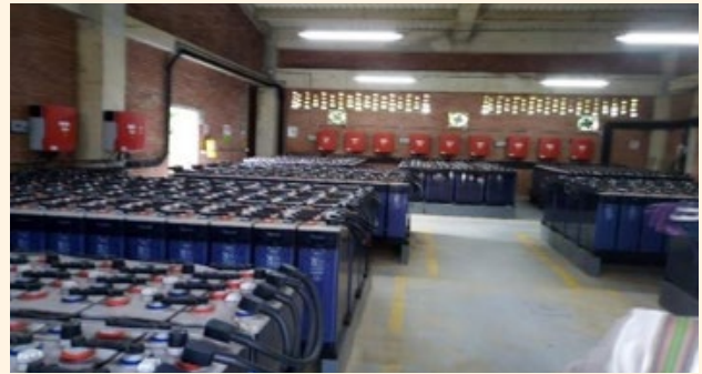
Banco de baterías
