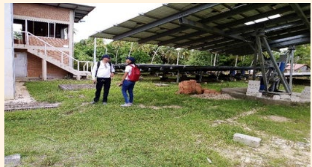
Instalaciones Administrativas y vista general del sistema Fotovoltaico
