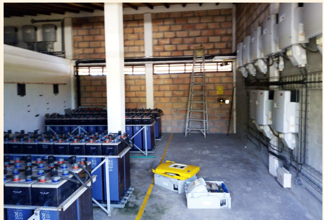
Detalle de la disposición de una de las áreas del sistema de almacenamiento, controladores e inversores
