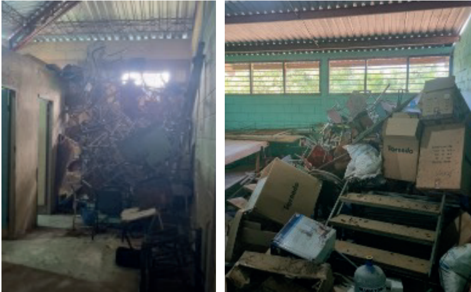
Imagen 2: Acumulación de escombros y mobiliario deteriorado en centros educativos
