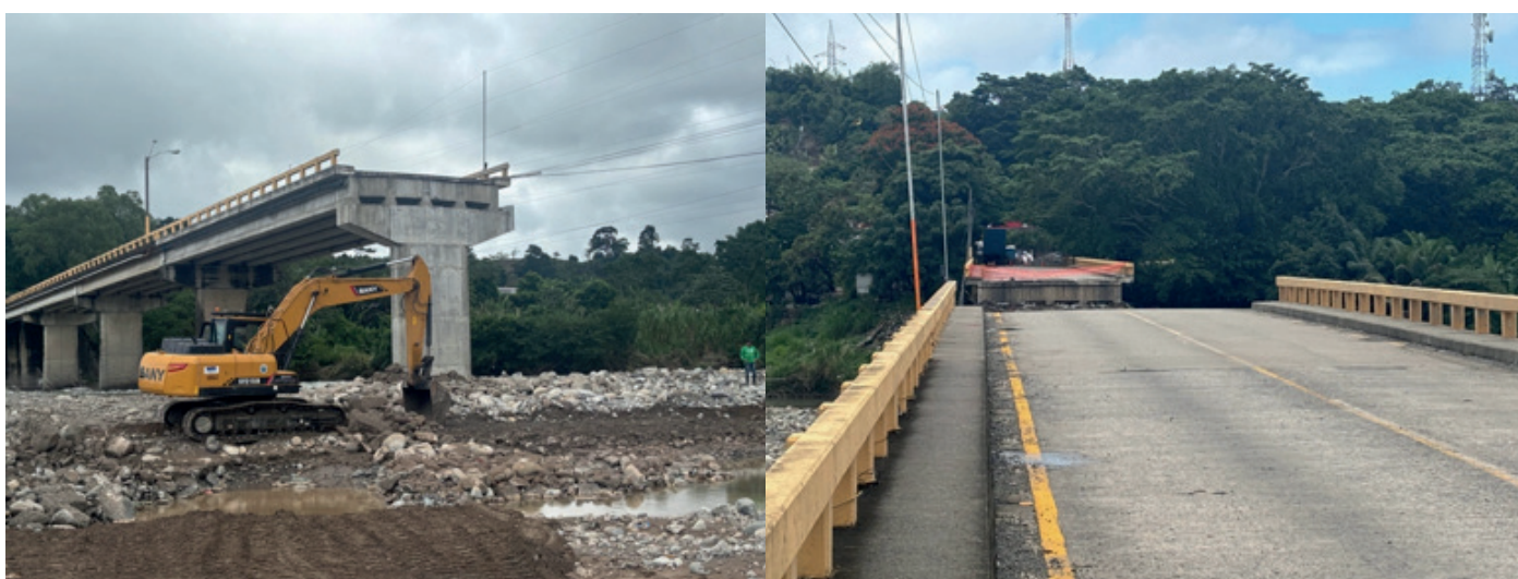
Imagen 13: Colapso de puente Saopín, La Ceiba, Atlántida
