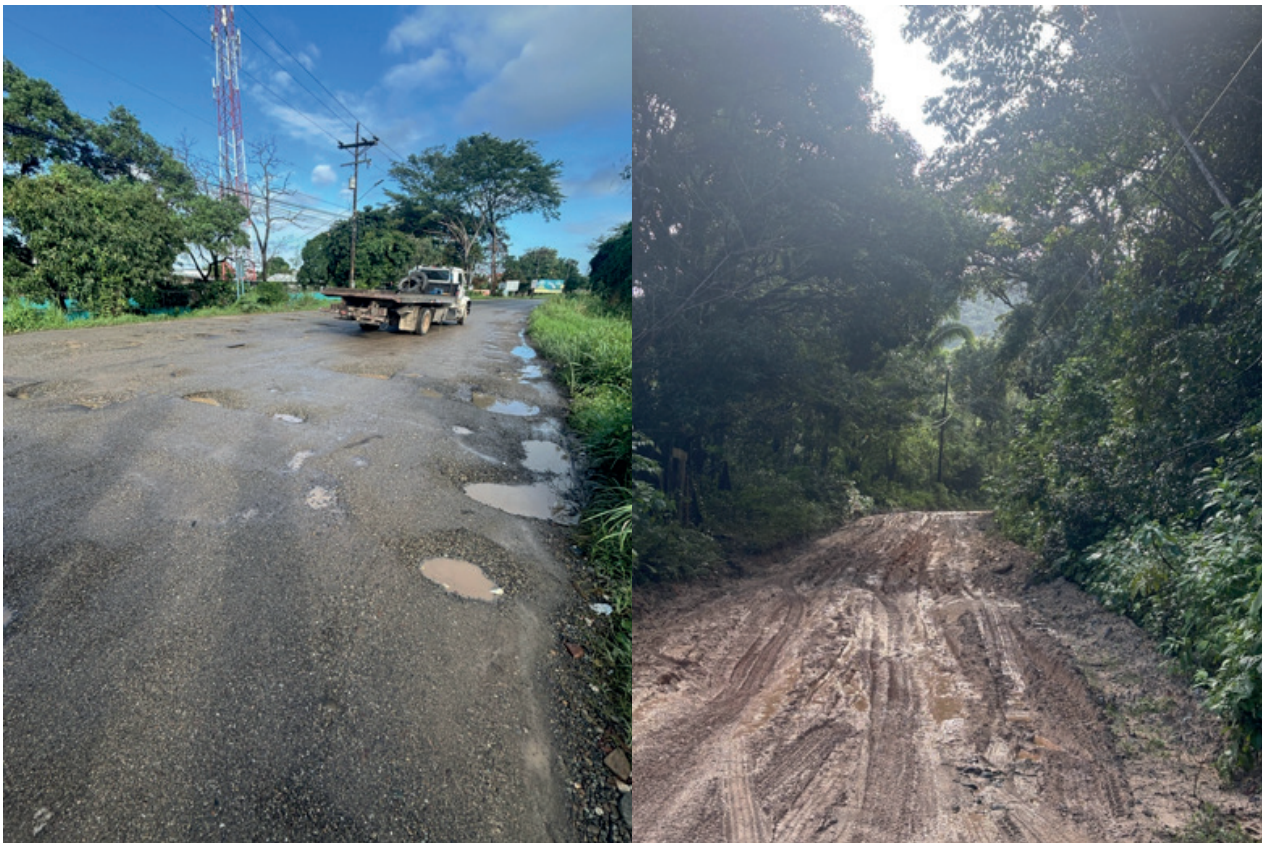
Imagen 12: Deterioro acelerado en caminos inundados
