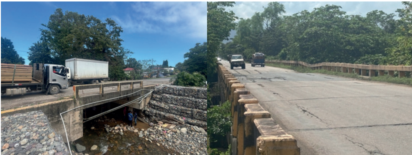
Imagen 14: Afectación parcial de puentes
