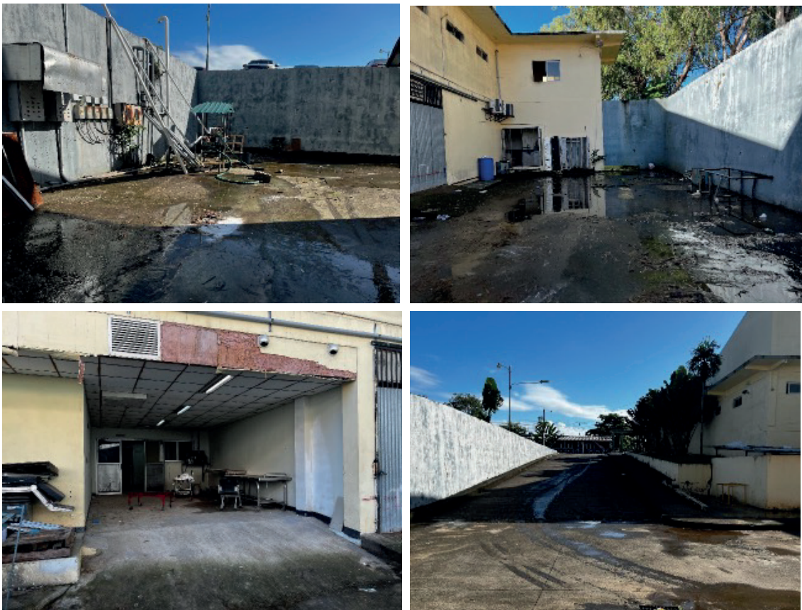
Imagen 3: Afectaciones en el Hospital General Atlántida
