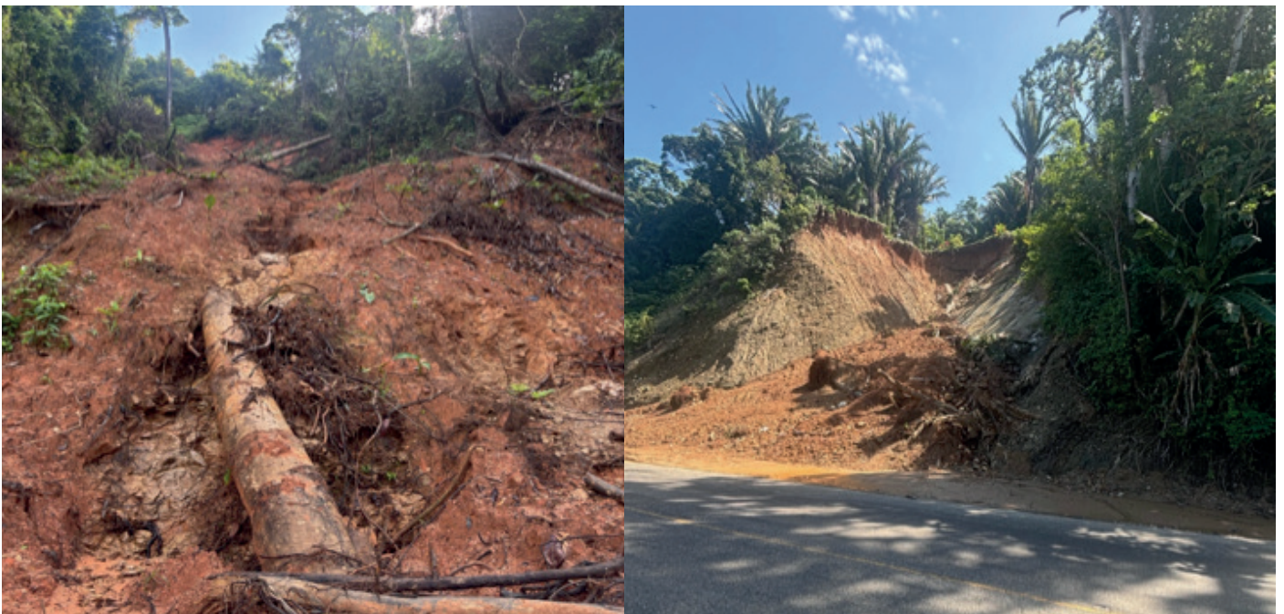
Imagen 15: Deslizamientos de suelo que afectaron caminos
