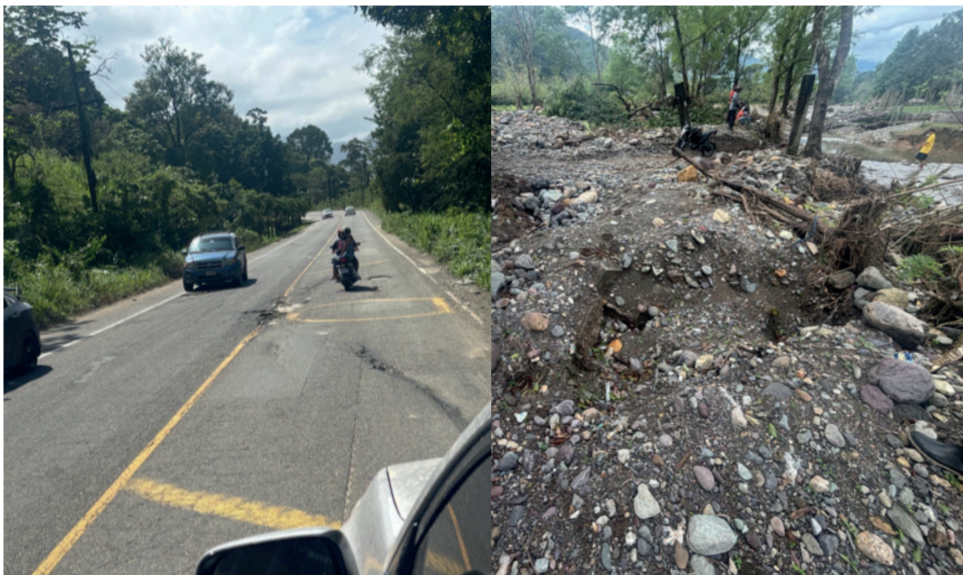
Imagen 11: Afectación inmediata en caminos
