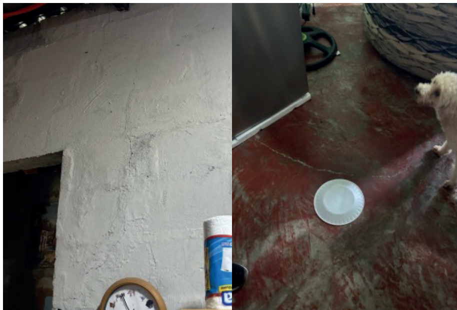
Imagen 5: Viviendas con grietas por asentamientos diferenciales
