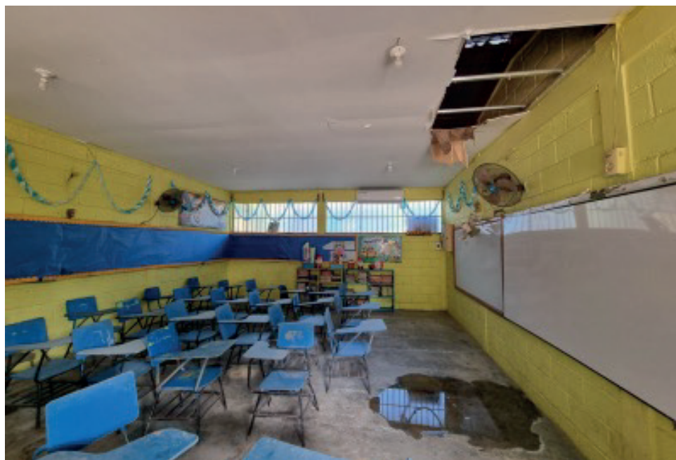
Imagen 1: Daños en infraestructura y mobiliario de centro educativo
