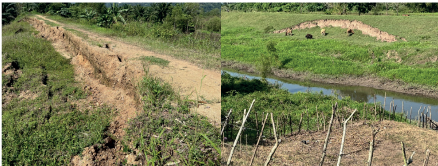
Imagen 8: Daños en bordos
