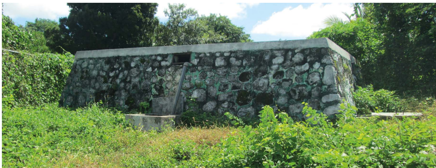
Tanque de agua.
