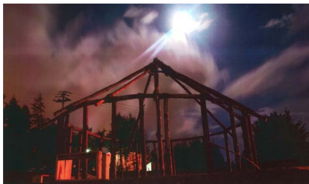
Subsidios 2009. Construcción de un edificio de estilo indígena (muisca) para impartir clases en la Universidad de Boyacá, Colombia.
