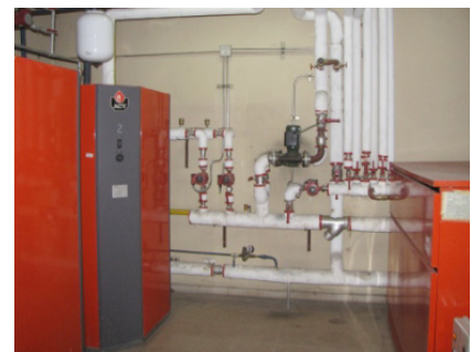
Sala de Calderas
