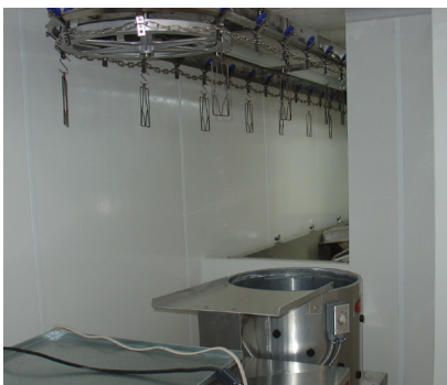
Sala de Proceso
