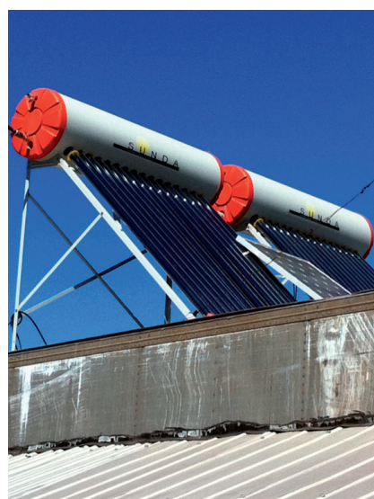
Vista Frontal Paneles Solares
