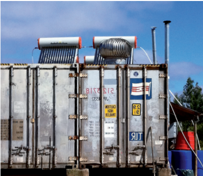
Vista Paneles Solares
