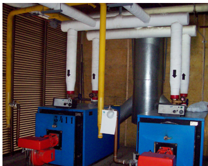
Sala de Calderas
