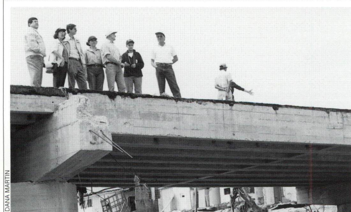
Funcionarios del BID evalúan los daños en Tegucigalpa.
