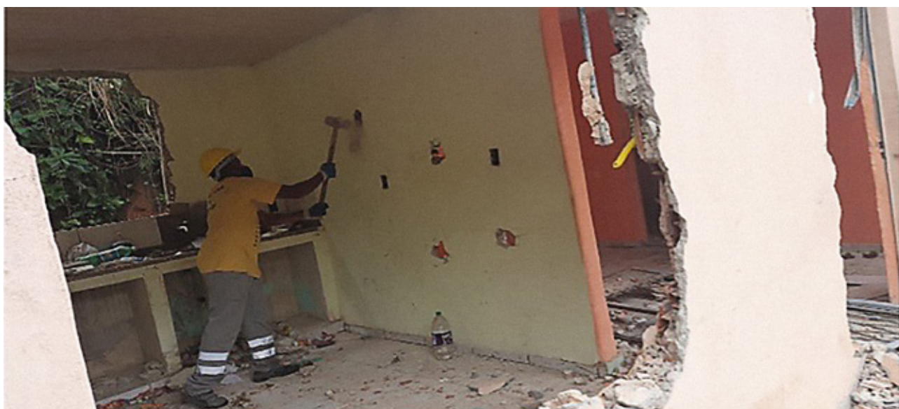
Foto 15 – Descaracterização do Imóvel
