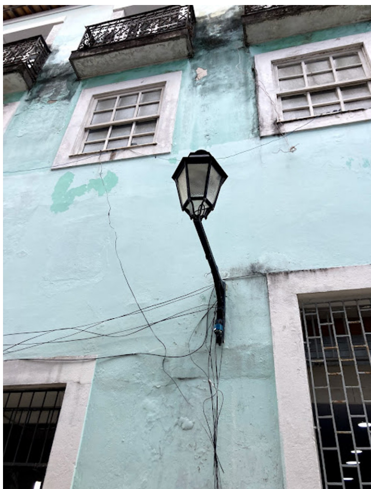
LUMINÁRIAS NAS PAREDES DOS IMÓVEIS DA RUA
