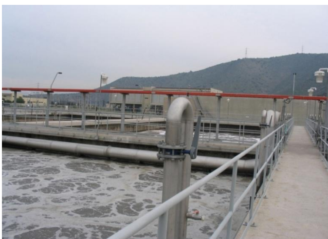
Sistema de lodo activado: superficie del reactor aireado.
