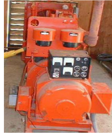
Generador que utiliza biogás como combustible.
