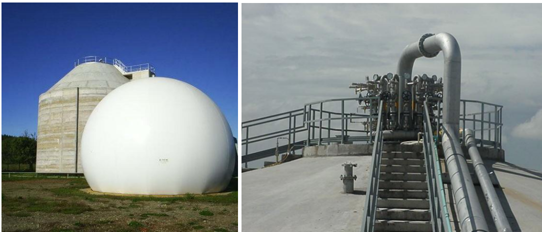
Digestor anaeróbico y almacenado de biogás en Planta de Tratamiento de Aguas Residuales (PTAR) en Osorno, Chile. Detalle de sistema de captura de gas en domo de digestor anaeróbico en otra localidad.
