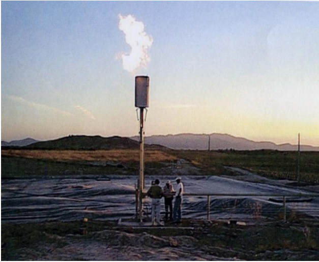
Laguna anaeróbica cubierta con sistema de quemado de biogás (Chile).
