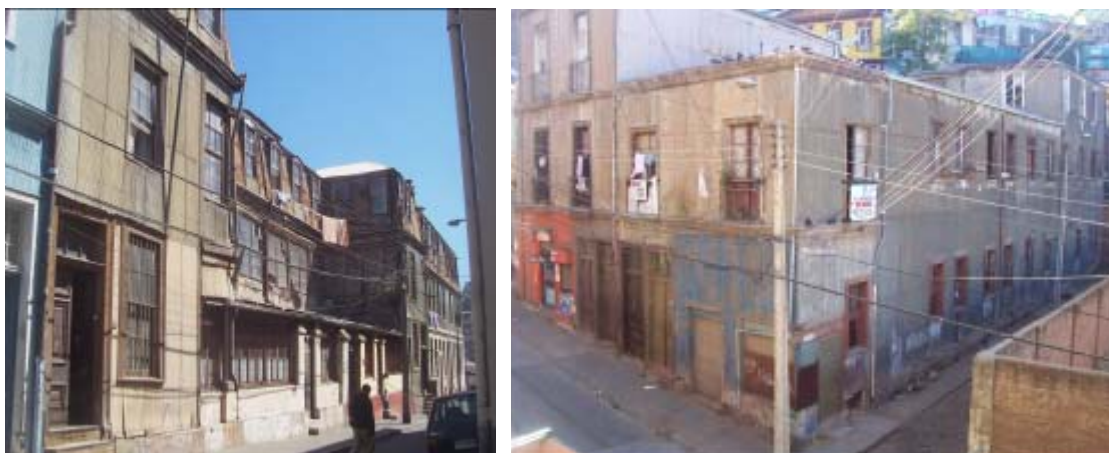
Figura 15. Ejemplos de viviendas deterioradas
